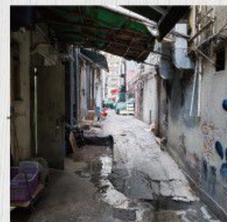
皇后大道西250號 (簷篷漏水)
